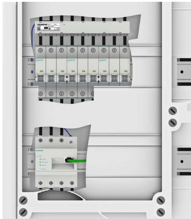
Установленная многоканальная система измерения тока 7KT PAC1200
